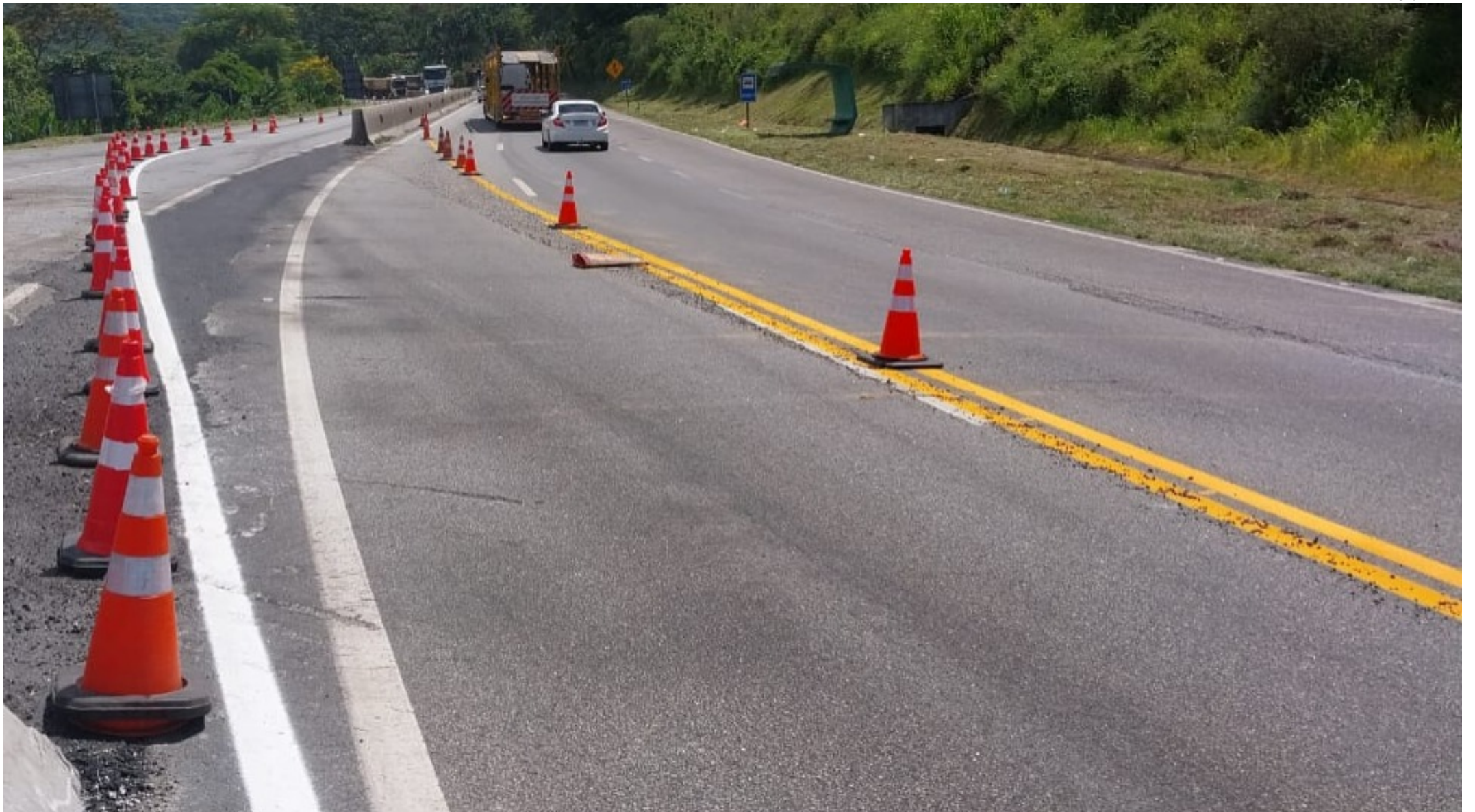
A pista da BR-277 sofreu um afundamento, apresentando rachaduras na altura do km 33,5, e precisou ser interditada
