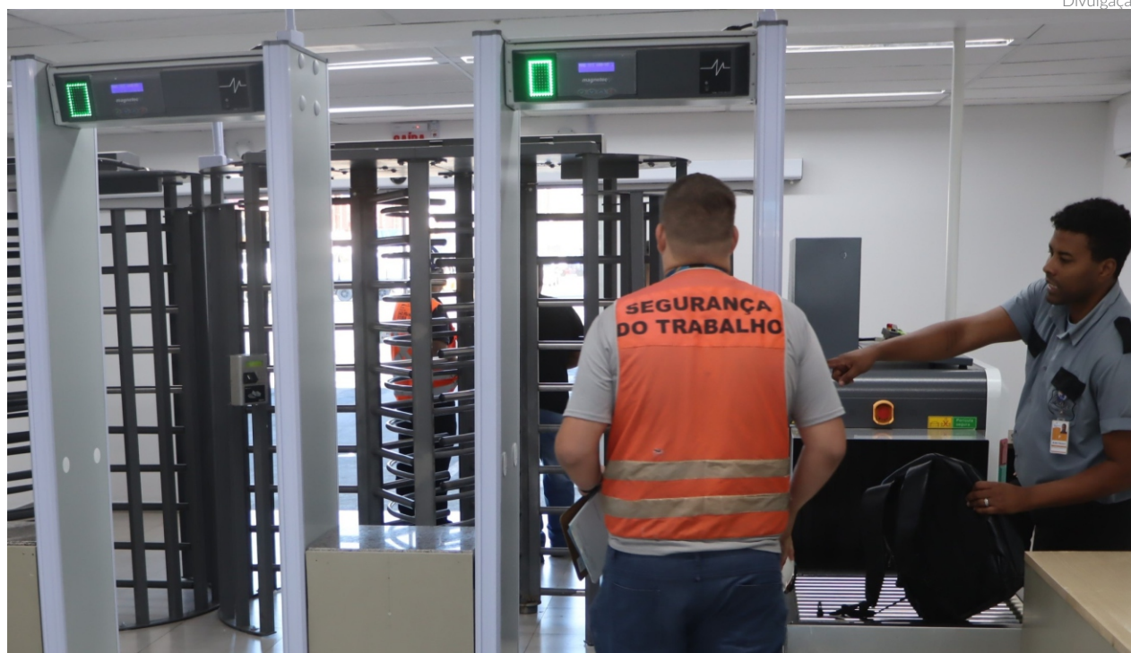
A nova instalação agora conta com quatro detectores de metais e quatro catracas torniquete, além de um scanner de bagagem, similar aos existentes em aeroportos
