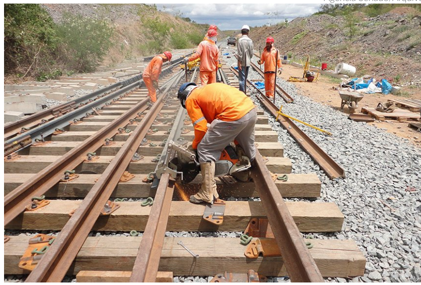
Um dos temas discutidos no Nordeste Export será a Transnordestina, cuja obra iniciou em 2008 e deveria ter sido concluída em 2012, mas segue em andamento até hoje
