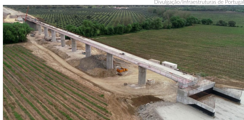
No total, são 170 km de linha ferroviária, das quais 80 km serão totalmente novos e 90 km reformados, mais a construção de 29 pontes
