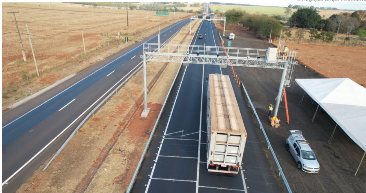
O funcionamento da balança se dará por meio de sensores de alta precisão instalados nas faixas principais da via e que aferem diretamente a carga durante a passagem do veículo
