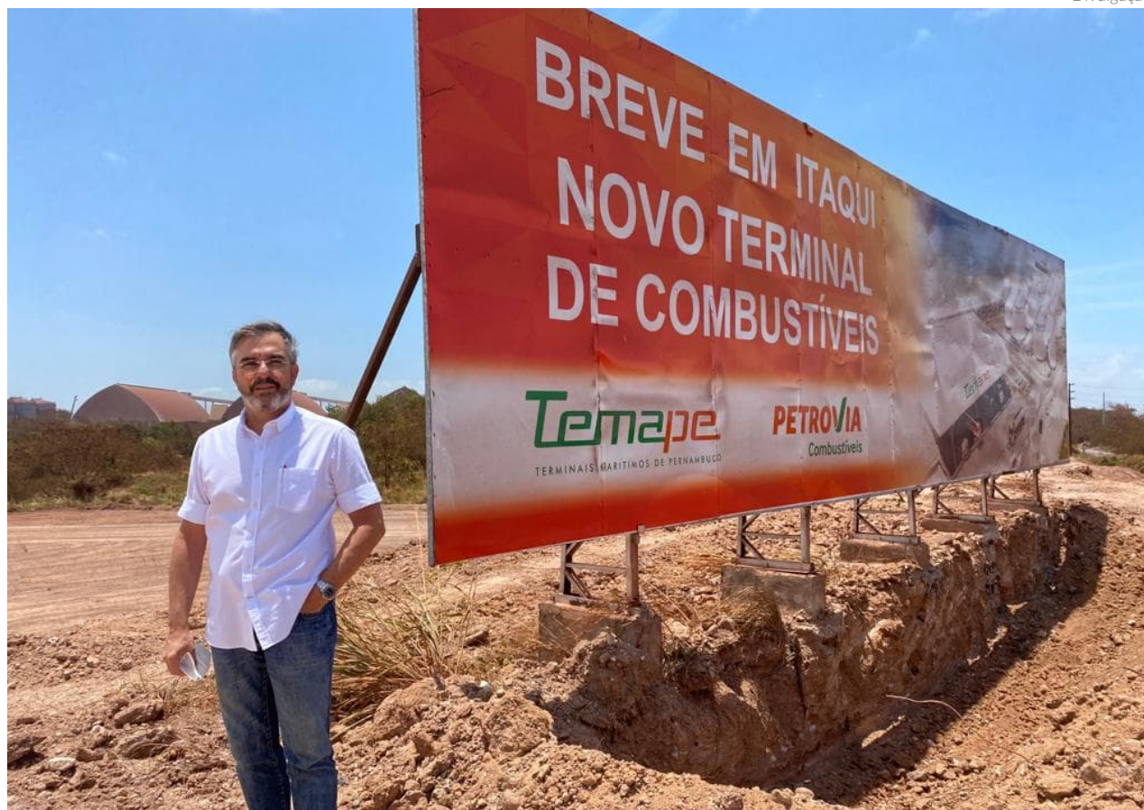
A Temape está implantando um novo terminal no Porto de Itaqui. As obras começaram em setembro do ano passado e estão 60% prontas, num investimento de R$ 187 milhões
