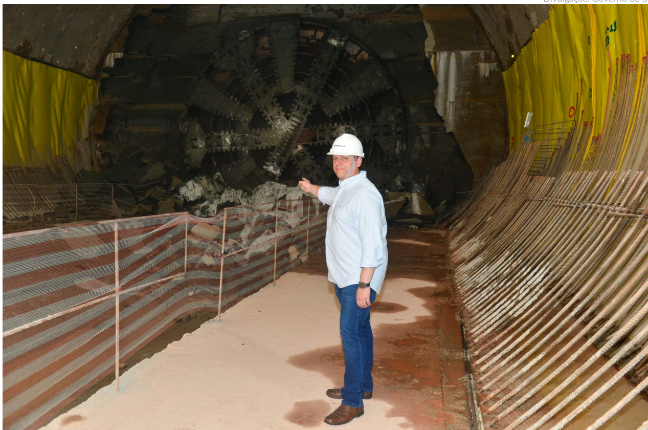
O governador Tarcísio de Freitas comentou sobre a parceria com o Governo Federal durante vistoria às obras do trecho sul da construção da Linha-6 Laranja do metrô da capital paulista
