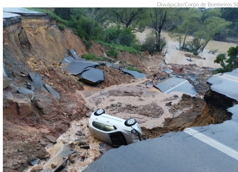
No momento do desabamento das pistas da BR-470, um veículo de passeio com dois idosos trafegava pelo local e caiu na cratera. As vítimas tiveram ferimentos leves
