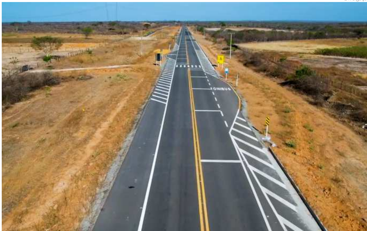
O trecho de 22,5 km da BR235-BA recebeu serviços de terraplenagem, pavimentação (sub-leito, sub-base, base e capa asfáltica) e implantação de sinalização horizontal e vertical
