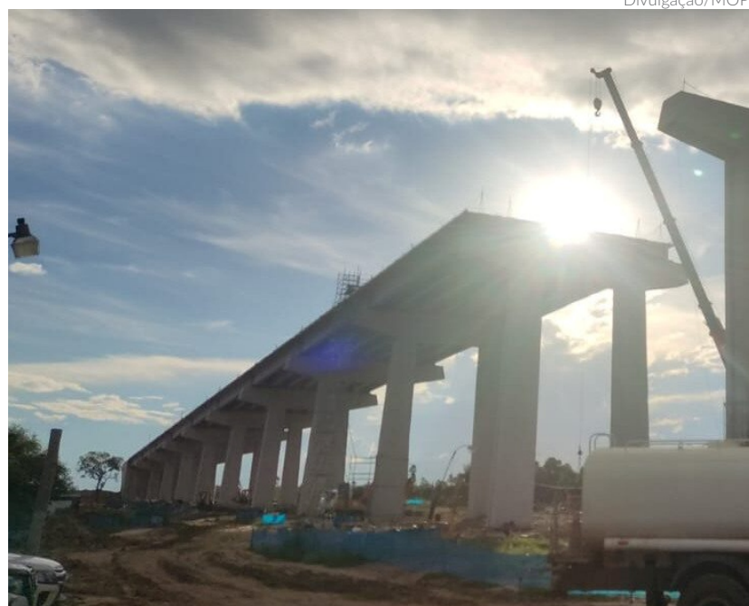
As fundações estão agora completamente instaladas, e o progresso é evidente tanto nos dois pilares principais quanto no tabuleiro dos viadutos de acesso da Ponte Bioceânica
