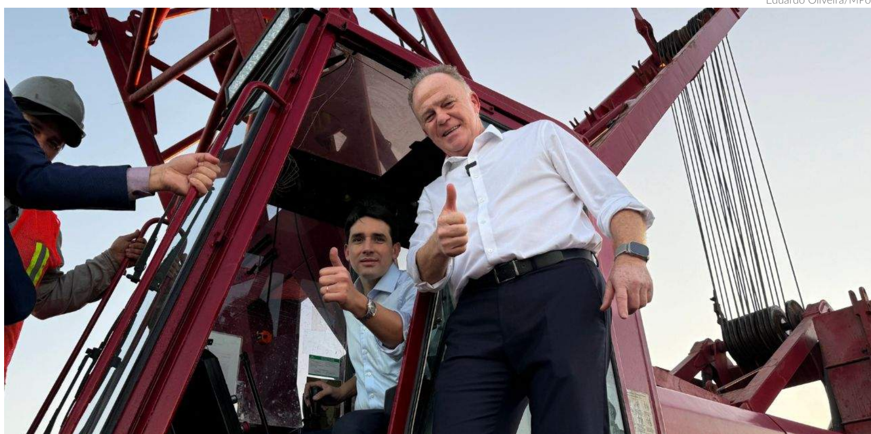
Silvio Costa Filho e o governador Renato Casagrande em um guindaste utilizado na obra: segundo o Ministério de Portos e Aeroportos, serão investidos R$ 2,7 bilhões no terminal
