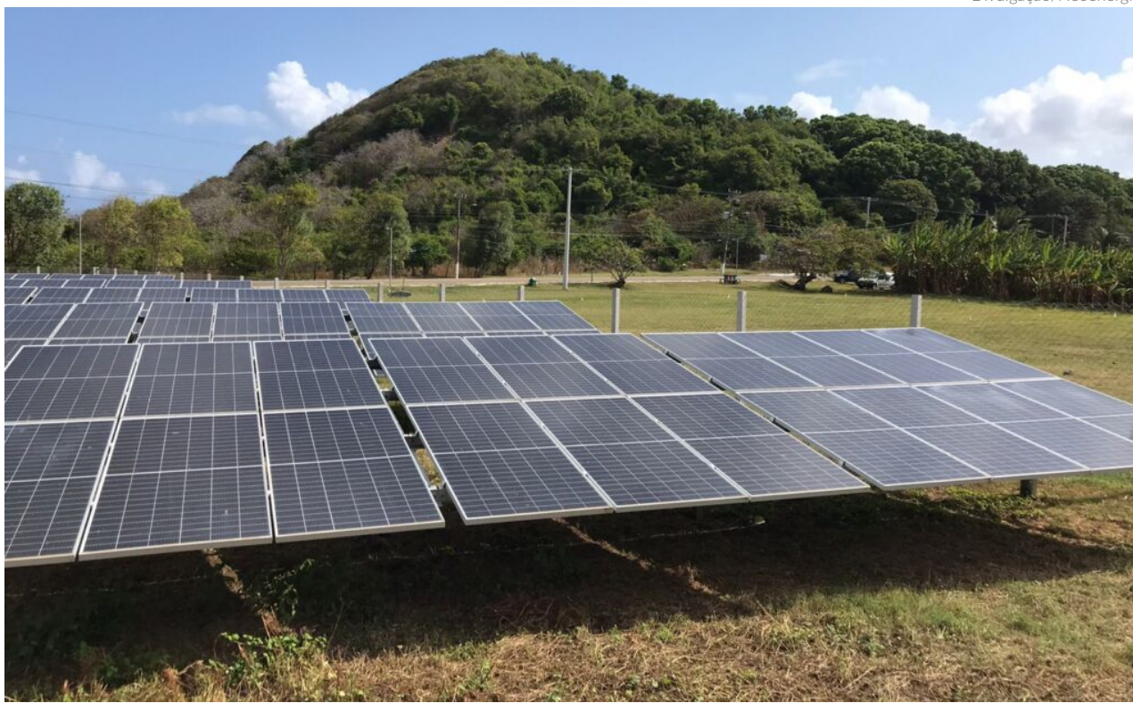
O objetivo do Governo é expandir a oferta de energia na ilha por meio de fontes renováveis, com ênfase na instalação de painéis fotovoltaicos associados a sistemas de baterias
