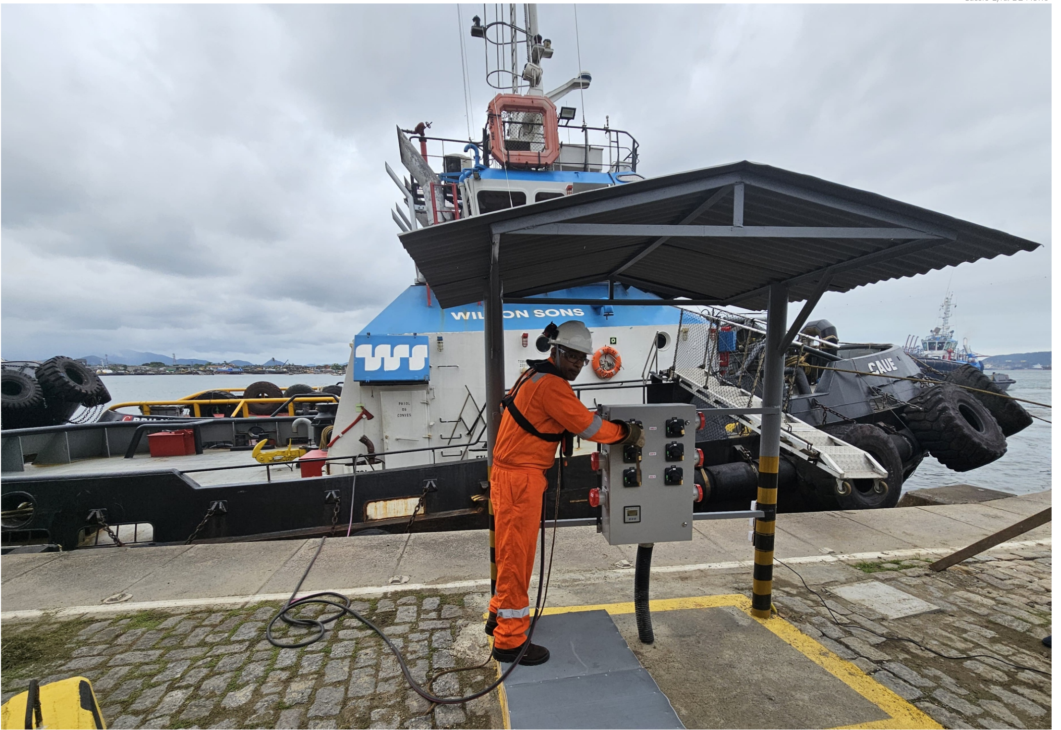
O sistema, conhecido como Onshore Power Supply (OPS), foi viabilizado em parceria com o Sindiporto e as cinco empresas que atuam com rebocadores no Porto de Santos
