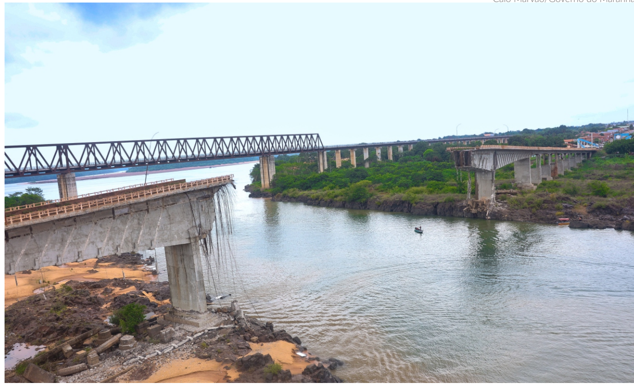
A queda da ponte Juscelino Kubitschek desencadeou investigações conduzidas pela Polícia Federal, que busca identificar as causas e eventuais responsáveis pelo colapso
