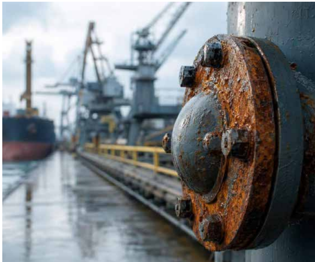
Pontos de oxidação, bolhas na pintura, alteração de cor dos revestimentos, perda localizada de material e vazamentos recorrentes estão entre os indícios mais comuns de corrosão
