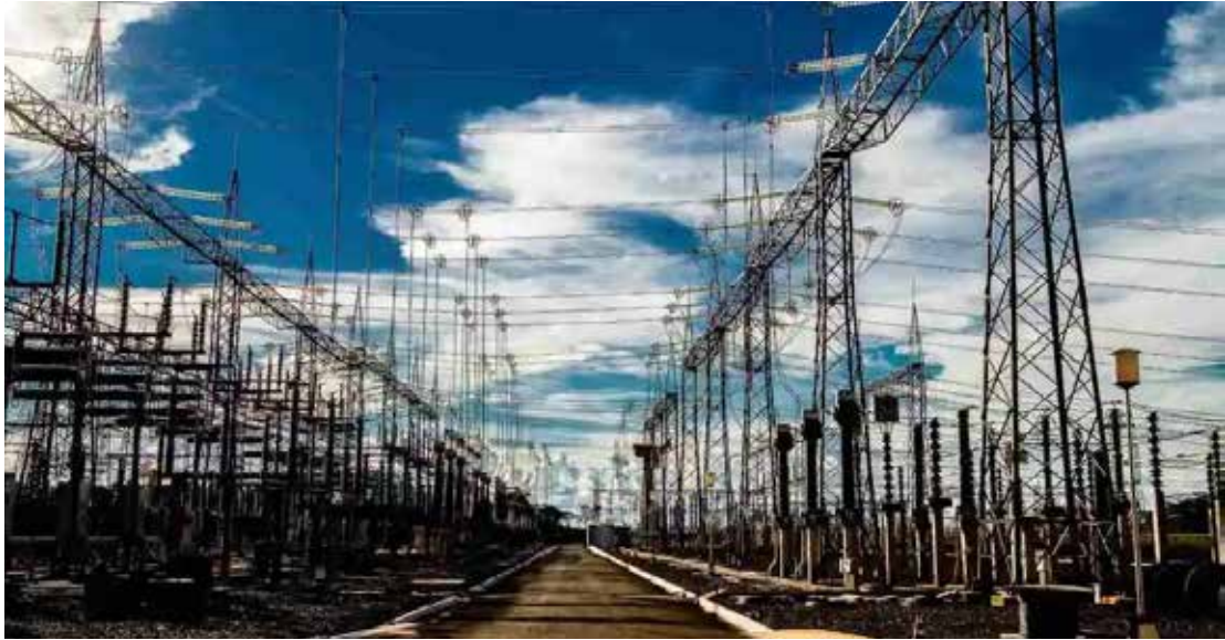
A Axia tem ampliado investimentos em projetos de reforços e melhorias em seus ativos de transmissão como estratégia para modernizar suas subestações e ampliar as receitas
