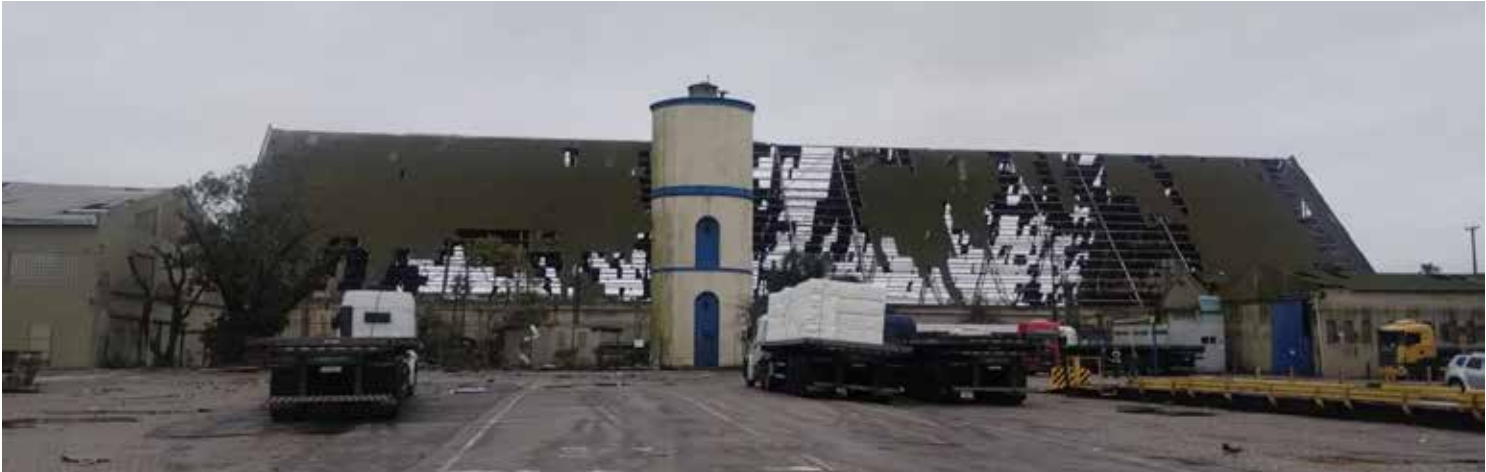
Equipes da Portos RS iniciaram na segunda-feira o levantamento dos prejuízos causados pelos ventos e a definição das medidas necessárias para recuperar as áreas atingidas
